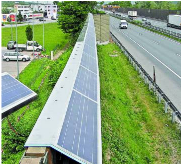
Lärmschutzwände entlang der Inntalautobahn bekommen eine zusätzliche und sinnvolle Funktion als Energielieferant.Foto: TIWAG
